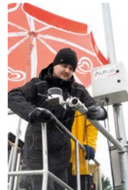
Abbildung 10: Verkabelung des Lidar-Sensors ©AustriaTech/Schallauer
